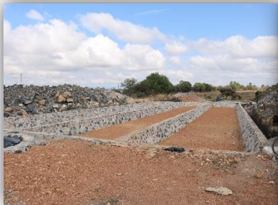
Planta de tratamiento
